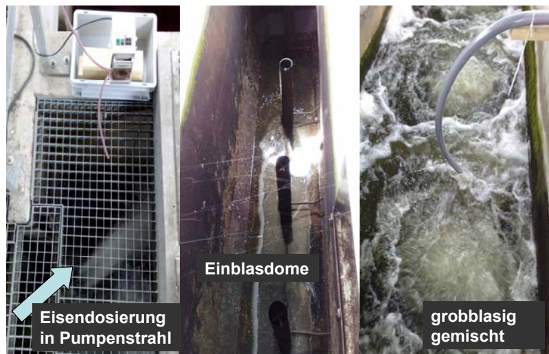
Abbildung 5A-C Dosierung von Eisen (III)-Chlorid (A) und PAK-Suspension (B+C) in den Flockungsreaktor
