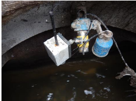
Capteur de niveau dans la bouche d'égout avec transmission radio (Photo: Frank Blumensaat, Eawag)
