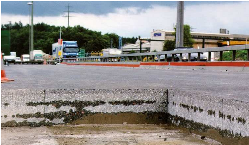
Abbildung 1: Belagsentnahme aus der A1-Autobahn nahe Lenzburg (CH). Am Rand der entstandenen Aussparung sind die unterschiedlichen Asphaltschichten gut erkennbar.
