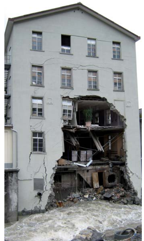
Bild 8. In Ziegelbrücke GL unterspülte die Rauti am 6. August eine alte Spinnerei (Kantonspolizei Glarus).
