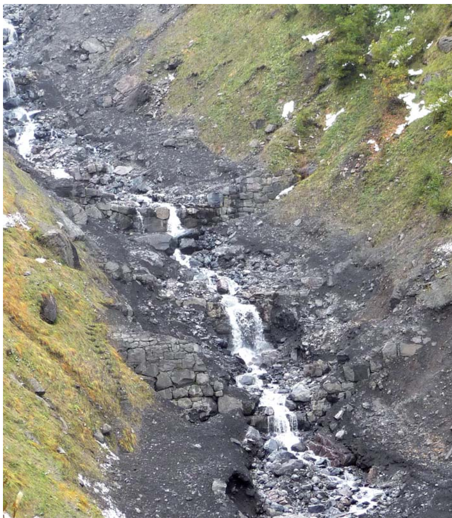
Bild 9. Murgänge beschädigten die Wildbachsperren in der Guppenrunse in Schwanden GL am 10. Oktober 2011 (Markus Gächter, Marty Ingenieure AG).
